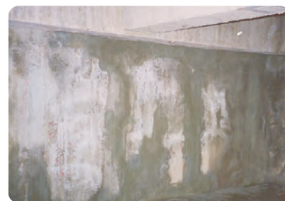
連續壁滲水止漏
